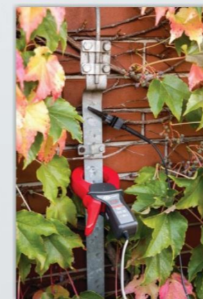
اندازه گیری مقاومت سیستم زمین بدون نیاز به جداسازی تجهیزات از سیستم زمین بکمک سه الکتروود و یک کلمپ (3P+)
