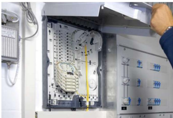
شکل ۶-۱۲: نمونه یک BEP نصب شده روی دیوار در کنار توزیع برق
