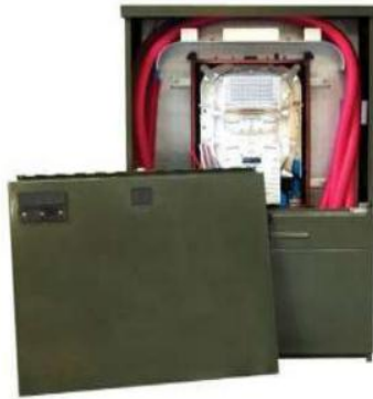
شکل ۷-۸: اتاق برق معمولی
