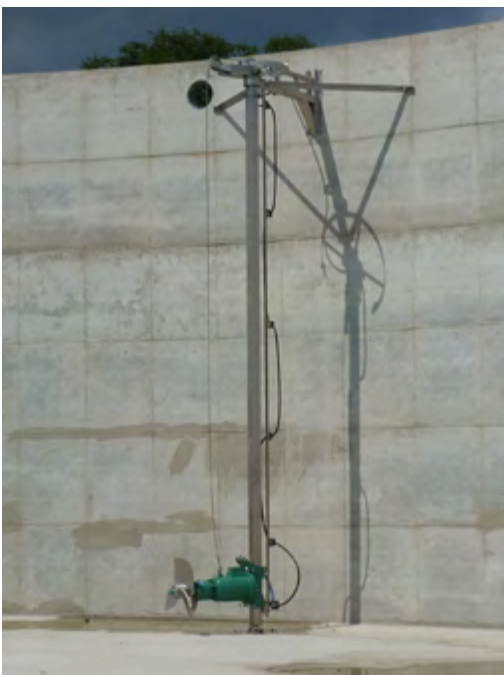
MGD - Betonbehälter mit 2G
