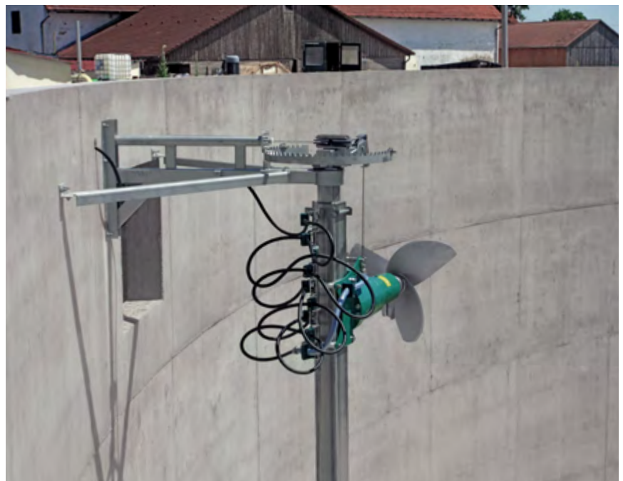
MGD - Betonbehälter mit 2G
